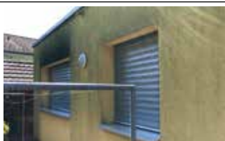
Vorher: Putzfassade mit Flechten- und Algenbefall
