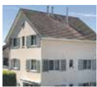
Tonziegeldach mit Schwarzalgenbefall.
