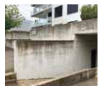
Vorher: Betonstützmauer mit Flechten- und Algenbefall
