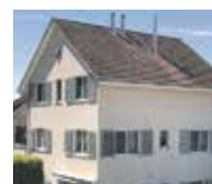
Tonziegeldach mit Schwarzalgenbefall.
