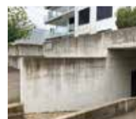
Vorher: Betonstützmauer mit Flechten- und Algenbefall
