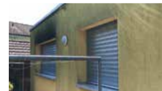
Vorher: Putzfassade mit Flechten- und Algenbefall
