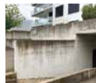
Vorher: Betonstütz-mauer mit Flechten- und Algenbefall
