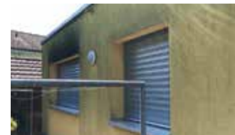
Vorher: Putzfassade mit Flechten- und Algenbefall
