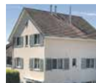
Tonziegeldach mit Schwarzalgenbefall.
