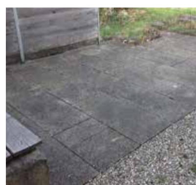
Sandsteinplatz mit Flechtenbefall.
