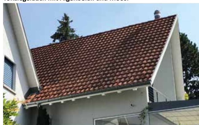
Tonziegeldach mit Algenbefall und Moos.
