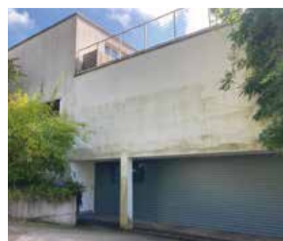
Putzfassade mit Grünalgenbefall.
