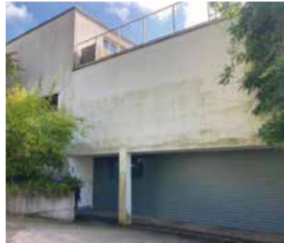
Putzfassade mit Grünalgenbefall.
