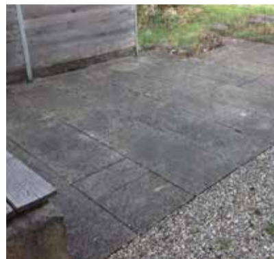
Sandsteinplatz mit Flechtenbefall.
