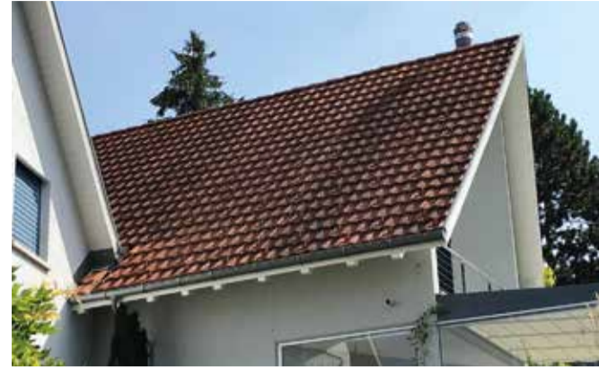
Tonziegeldach mit Algenbefall und Moos.
